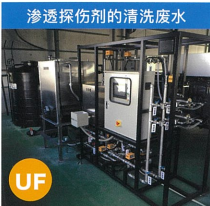
渗透探伤剂的清洗废水 凭借稳定的脱色处理, 实现省人化 (通过高浓度时的药剂调整, 无需进行脱色性确认)
