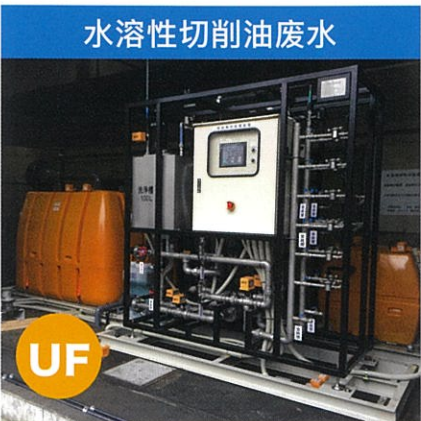
水溶性切削油废水 提高蒸发处理装置的处理效率 (通过预处理, 去除大量的混入油分)
